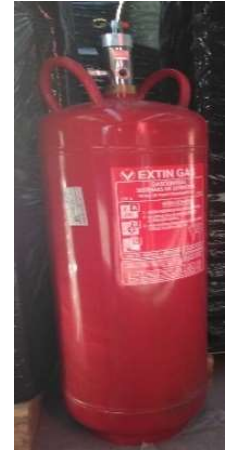
Figura 3.- Contenedor del agente extintor.
