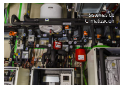
Sistema Activo de Envoltente conectado a sistemas de climatización (imágenes inferiores) estando ambos gobernados por un Sistema de Gestión Inteligente (imagen superior).
